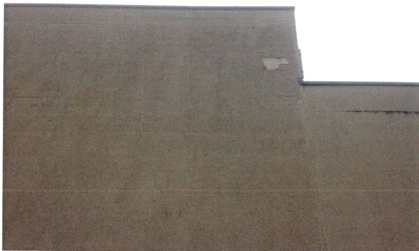
Figura 3: vista del distaccamento dell'intonaco plastico superficiale dalla facciata
