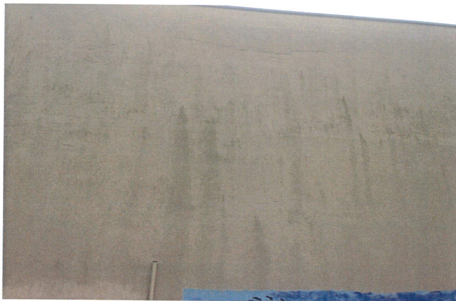
Figura 2: vista del degrado dell'intonaco della facciata
