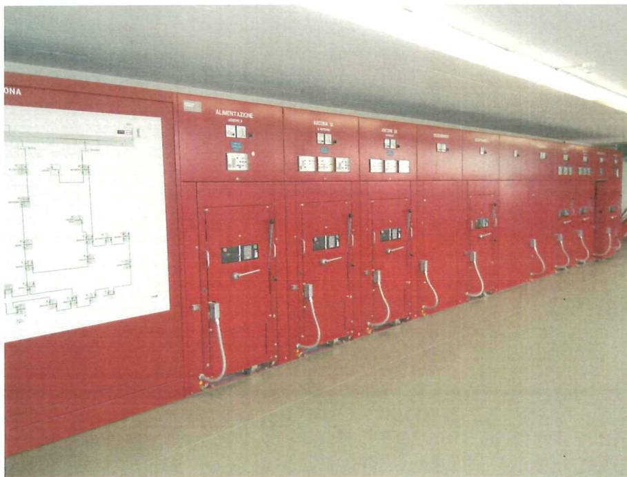
Figura 2: Interruttori MT dove arrivano e partono i cavi MT
