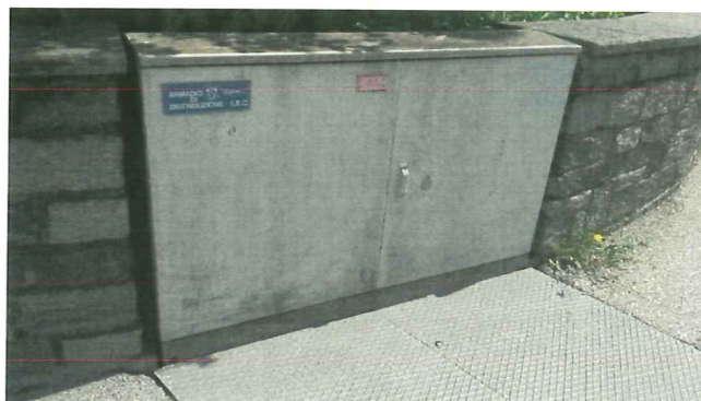
Figura 3: Armadio esistente che sarà sostituito
