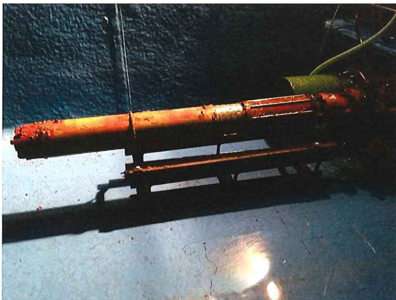
Figura 2: Pompa per l'alimentazione degli idranti
