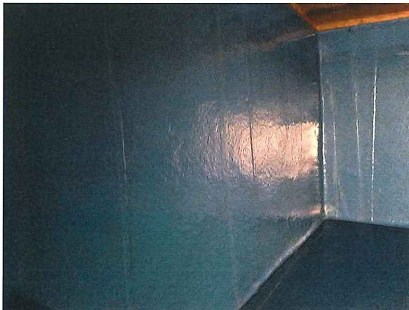
Figura 6: Immagine dell'interno di una vasca ricoperta con la plastica sarnafil
