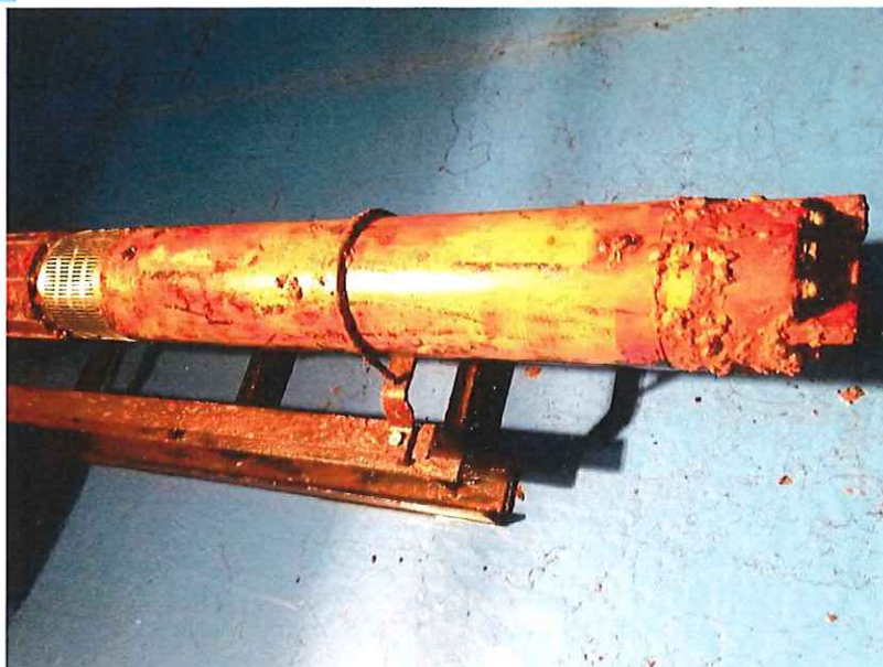
Figura 3: Pompa per l'alimentazione degli idranti
